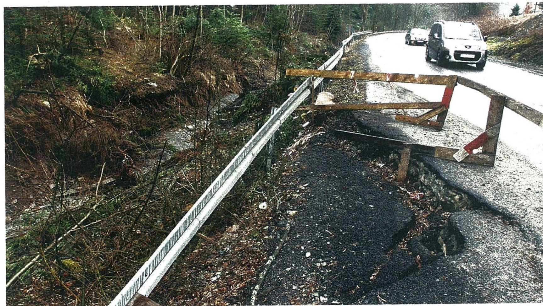
Groźne osuwisko zabrało już spore fragmenty drogi powiatowej w Librantowej koło Nowego Sącza
