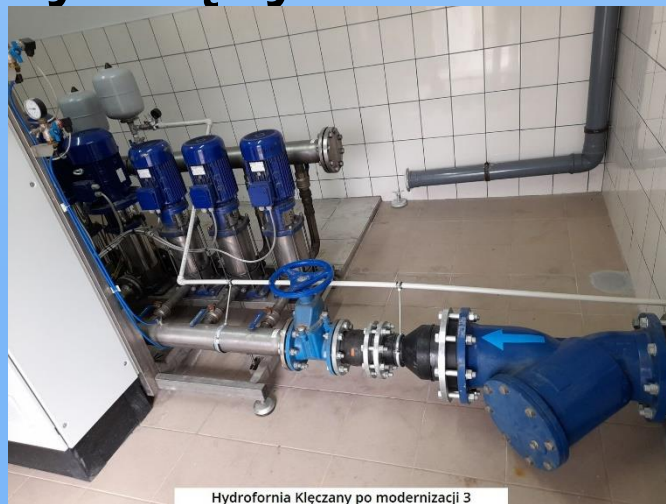
Hydrofornia Kłęzany po modernizacji 3
